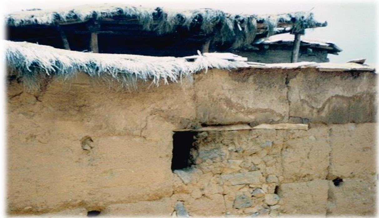
קירות בית חֶמֶר וגג מחופה סוף וקיר חיצוני שלא טויח רזה. עד שנעלם. צילמתי בטמזרסט
